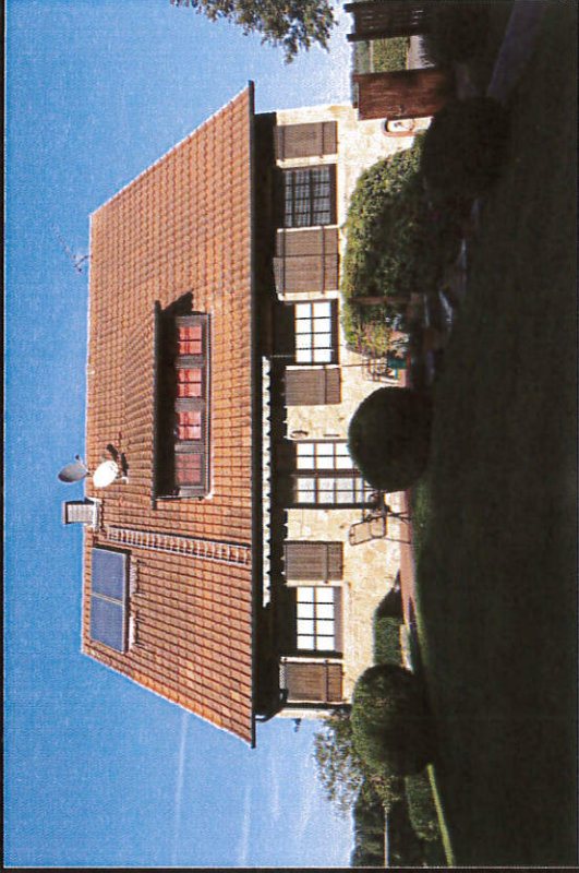
Pfarrhaus, Blick von Norden. Im Garten wurde der Boden nachträglich aufgeschüttet. (LWL-DLBW)
